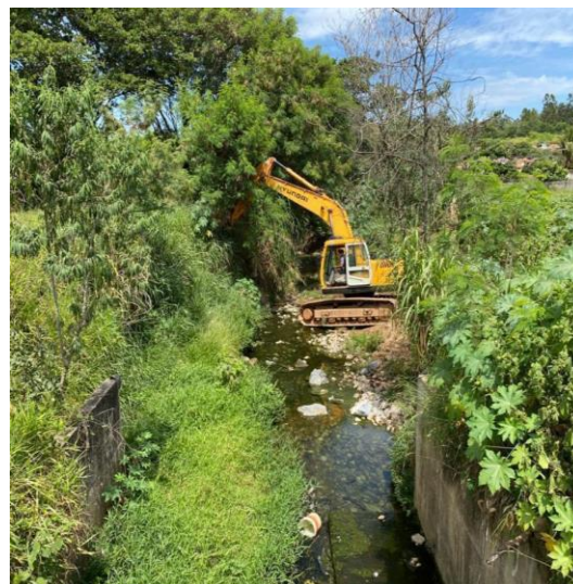
Figura 8 – Tombamento de material
