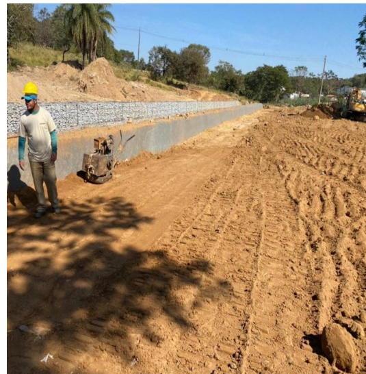
Figura 26 – Tombamento de material
